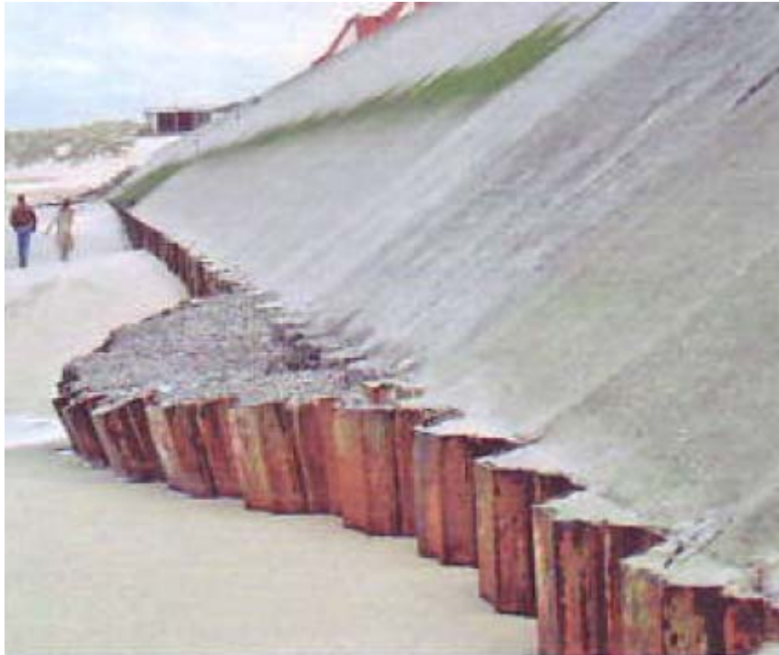
Bombement des palplanches constaté entre les 2 tempêtes de 2007.
