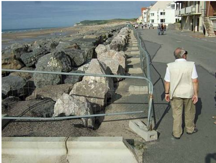
La protection par enrochement a été généralisée sur toute la hauteur du parement de la digue.
