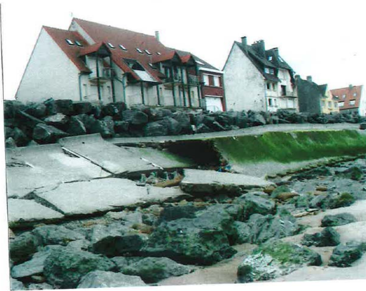
Effondrement du perré en mars 2008
